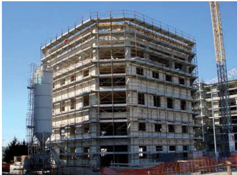
Εικόνα 4.2. Κτίριο γραφείων στην Ιταλία (46 HDR μονωτήρες).
