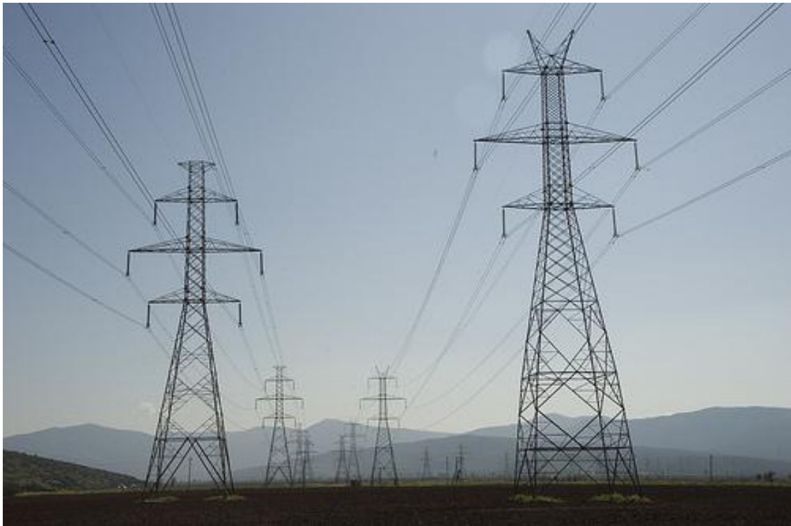
Δικτυωτοί μεταλλικοί πλώνες μεταφοράς ηλεκτρικής ενέργειας
