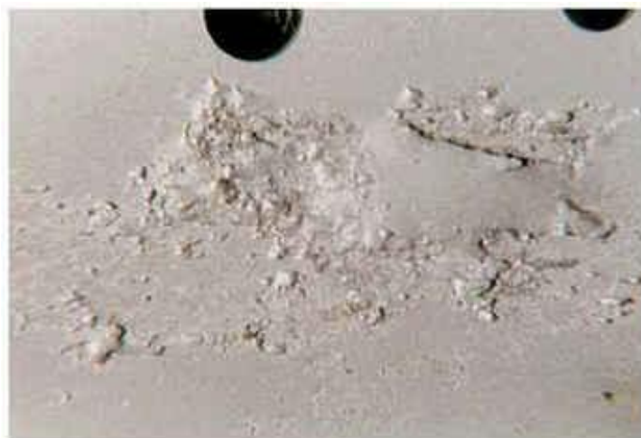
Εικόνα 8: Χαρακτηριστική μορφή εμφάνισης διάβρωσης εξάνθησης [10].
