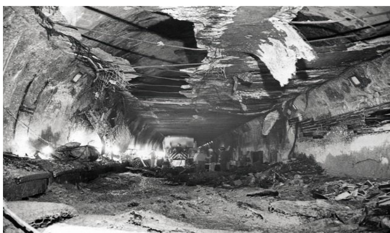
Εικόνα 1 Εσωτερική όψη της σήραγγας Holland μετά το ατύχημα
