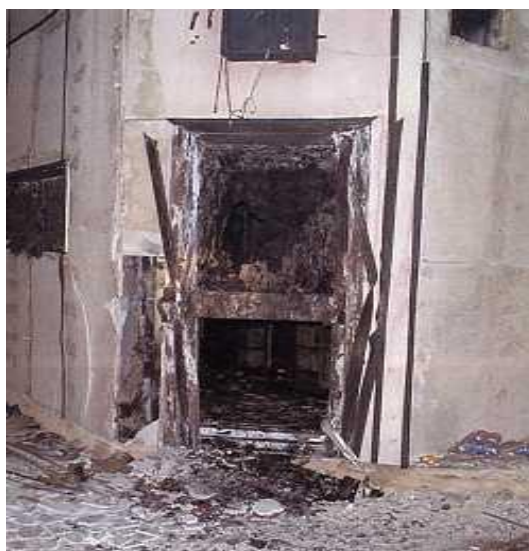
Εικόνα 3.7 Η είσοδος ενός καταφυγίου μετά το τέλος της φωτιάς (Mont Blanc tunnel accident 2001)
