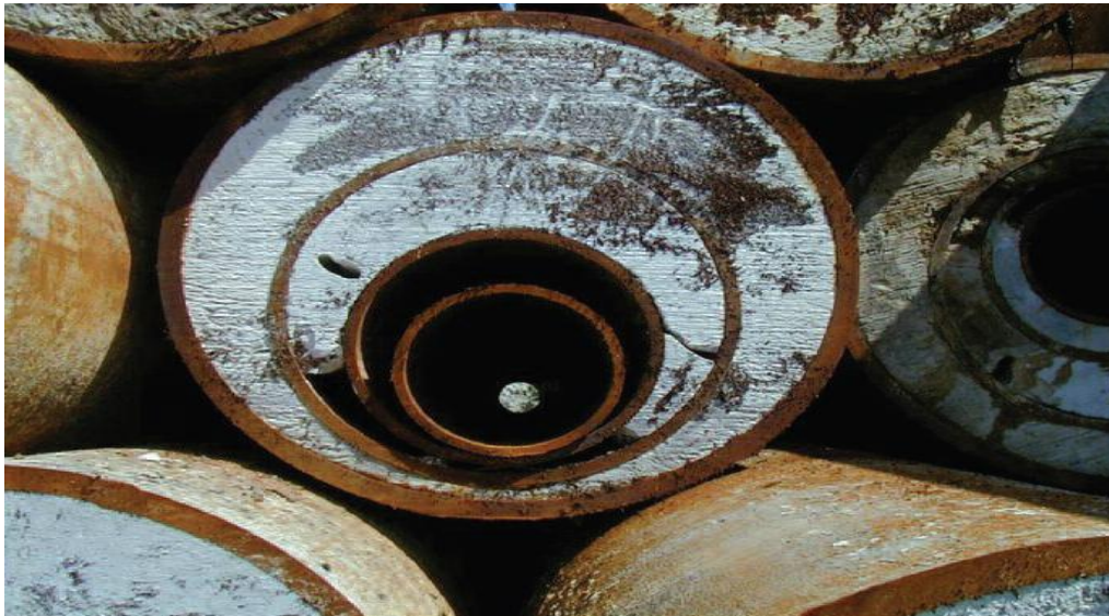
Εικόνα 2.4: Διαδοχικές σωληνώσεις και τσιμεντώσεις που δεν έχουν εφαρμοστεί σωστά καθώς πρέπει κάθε φορά να είναι τοποθετημένη στο κέντρο η σωλήνωση και η τσιμεντώση να έχει παντού το ίδιο πάχος. (Πηγή: The American Oil & Gas Reporter)
