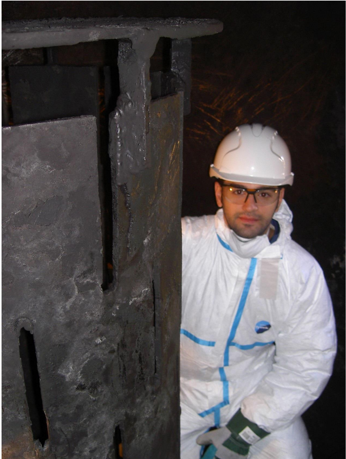
Εικόνα Β.3.Εσωτερικό του πύργου απόσταξης καθαρισμένο από το κωκ. Διακρίνονται τα σημάδια- χαρακές στα τοιχώματα του, από το κομπρεσέρ που σπάει το συσσωρευμένο κωκ. Ο εξοπλισμός, που φαίνεται (ολόσωμη στολή, προστατευτικά γυαλιά, κράνος και μάσκα για τα αιωρούμενα σωματίδια, καθώς και ανάλογα μποτάκια με προστατευτικό μέταλλο για τα πόδια) είναι απαραίτητα και τα φέρει όλο το προσωπικό που εργάζεται στην διάρκεια του Shutdown
