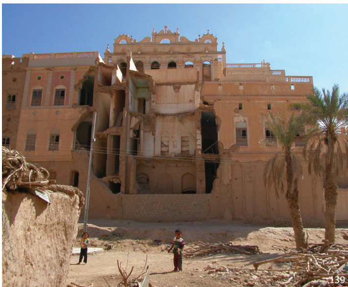
εικ.139: Δυτική όψη που κατέρρευσε το 2000
