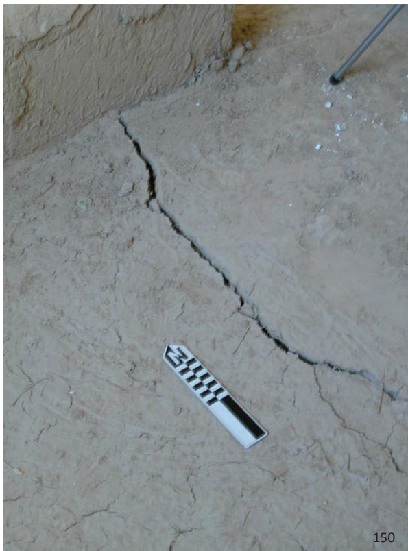
εικ.150: Εμφάνιση συρρίκνωσης και υποχώρισης στο νέο υλικό που προστέθηκε το λάδι πάνω από την τελική στρώση του ασβεστοκονιάματος
