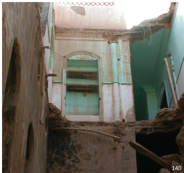
εικ.140: Κατάρρευση πατωμάτων και στέγης στο εσωτερικό της κουζίνας της βορειοανατολικής πτέρυγας
