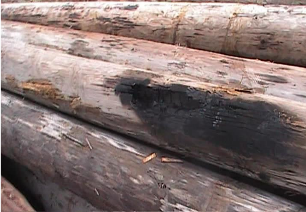
Φωτογραφία 5: στύλος με εμφανή σημάδια καψίματος και σήψης λόγω πιθανής διαρροής
