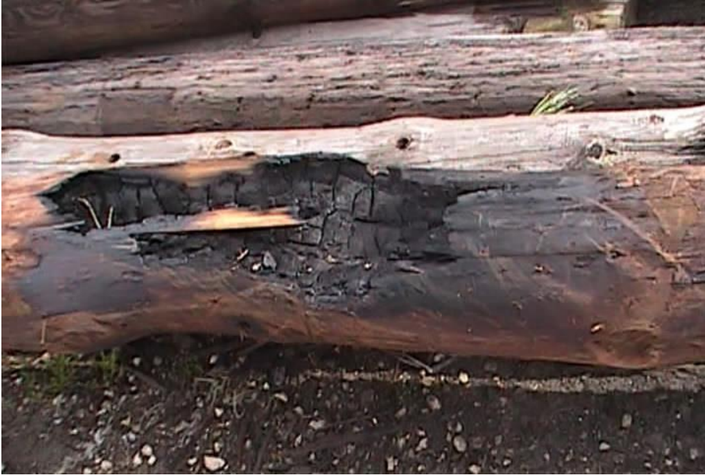
Φωτογραφία 3: στύλος με εμφανή σημάδια καψίματος και σήψης λόγω πιθανής διαρροής
