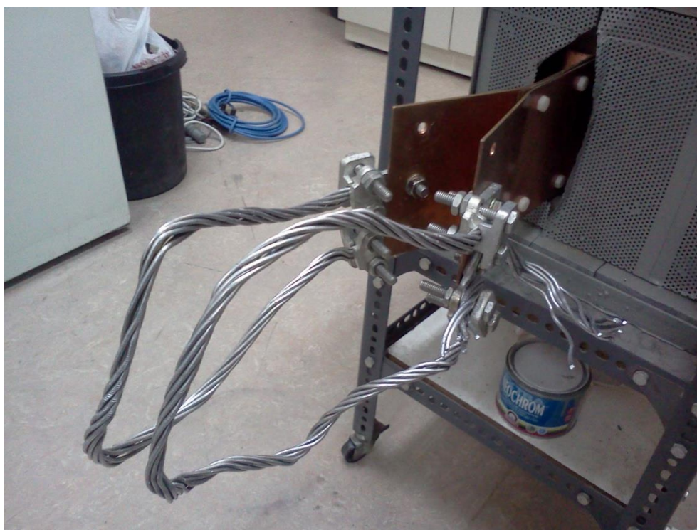
Σχήμα 3-7: Σύνδεση αγωγών ACSR στον Μ/Σ
