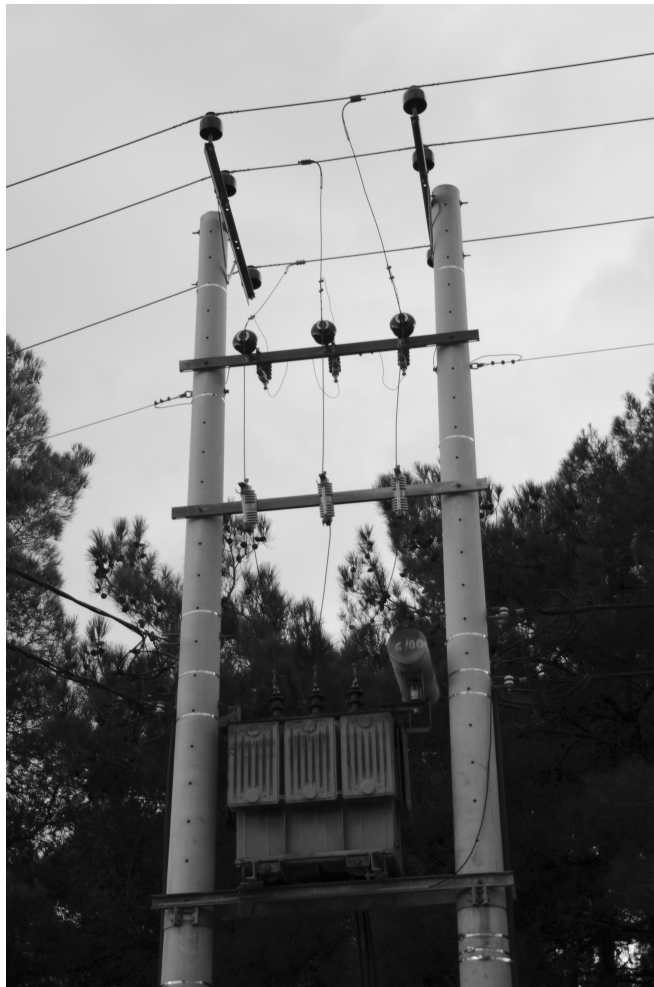
Σχήμα 2.4: Φωτογραφία τυπικού υποσταθμού σε δίστηλο
