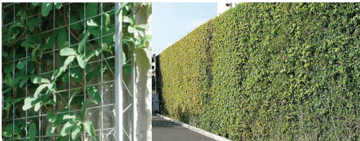
Εικόνα 1.13. Πράσινη πρόσοψη τύπου «Modular trellis panel system». [Πηγή: http://www.greenscreen.com/Resources/download_it/IntroductionGreenWalls.pdf ]
