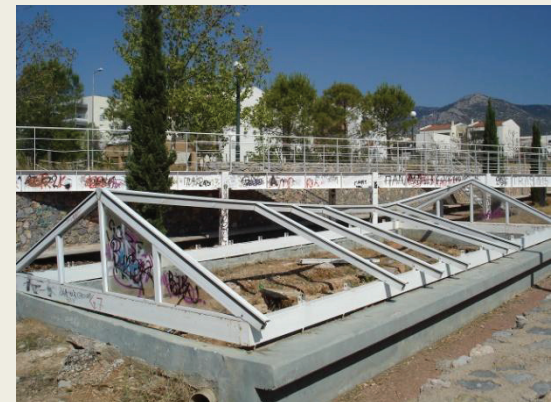
Εγκατάλειψη κοινόχρηστων χώρων
