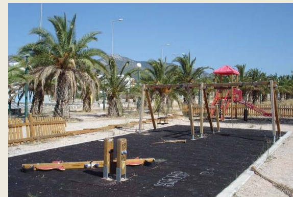
Εγκατάλειψη κοινόχρηστων χώρων
