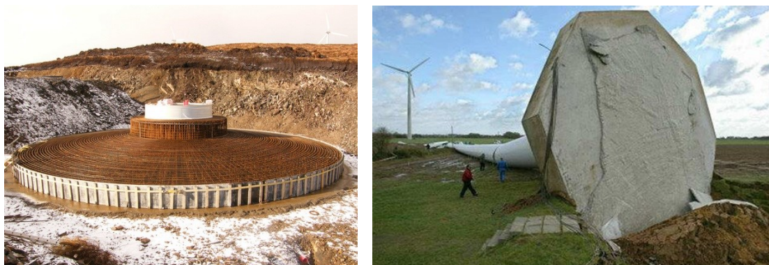
Εικ. 3.29 (α) Σκυροδέτηση θεμελίου πύργου Α/Γ (β) αστοχία πύργου Α/Γ λόγω ισχυρής καταιγίδας [Πηγή: Ontario Wind Resistance: http://ontario-wind-resistance.org ]
