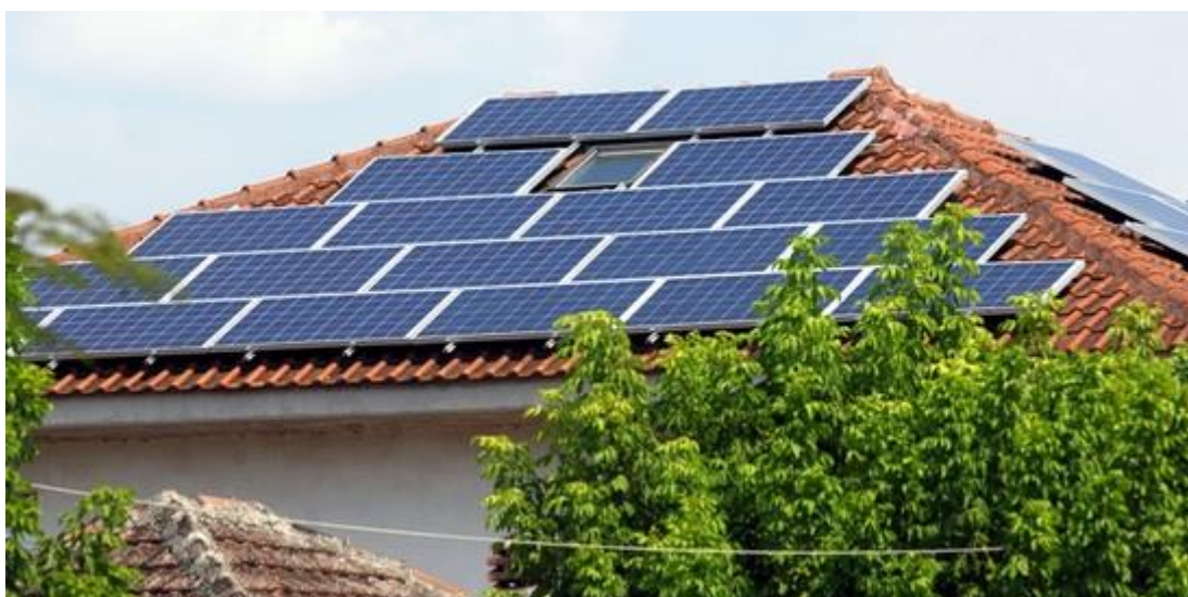
Εικόνα 1.6: φωτοβολταϊκά σε σκεπή σπιτιού (πηγή: www.buildnet.gr )
