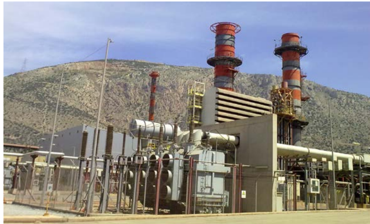
Φωτογραφία 6.1.1: Σταθμός Συμπαραγωγής Ηλεκτρισμού και Θερμότητας Ενεργειακού Κέντρου Αγ. Νικολάου
