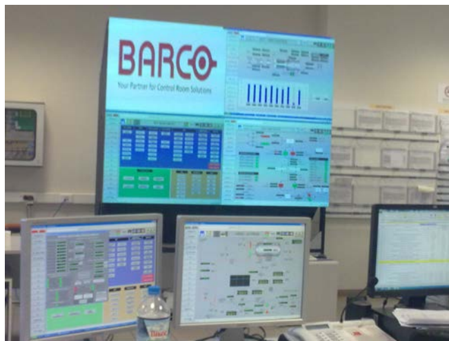
Φωτογραφία 6.2.4: Control Room
