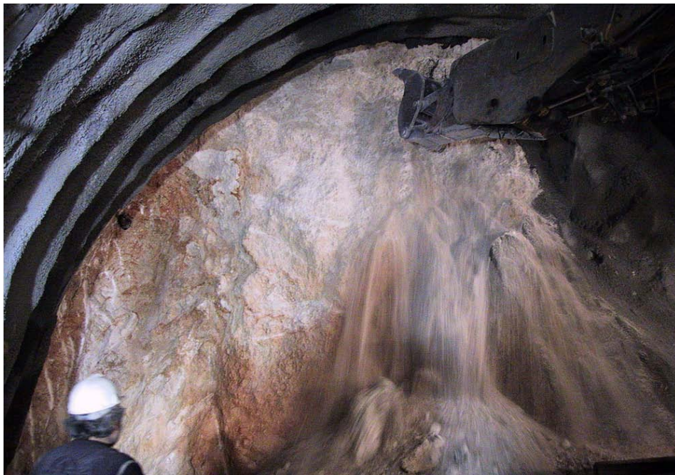
Εικόνα 1.6: Καταρρεόν υλικό στο μέτωπο σήραγγας (Μαρίνος, 2009)
