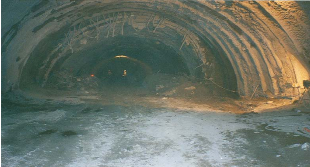
Εικόνα 1.9: Σήραγγα. Τυμφορηστού. Φαινόμενα σύνθλιψης στον φλύσχη: σύγκλιση οροφής σε σήραγγα σε περιβάλλον ασθενούς διατημημένου φλύσχη (Μαρίνος, 2009)
