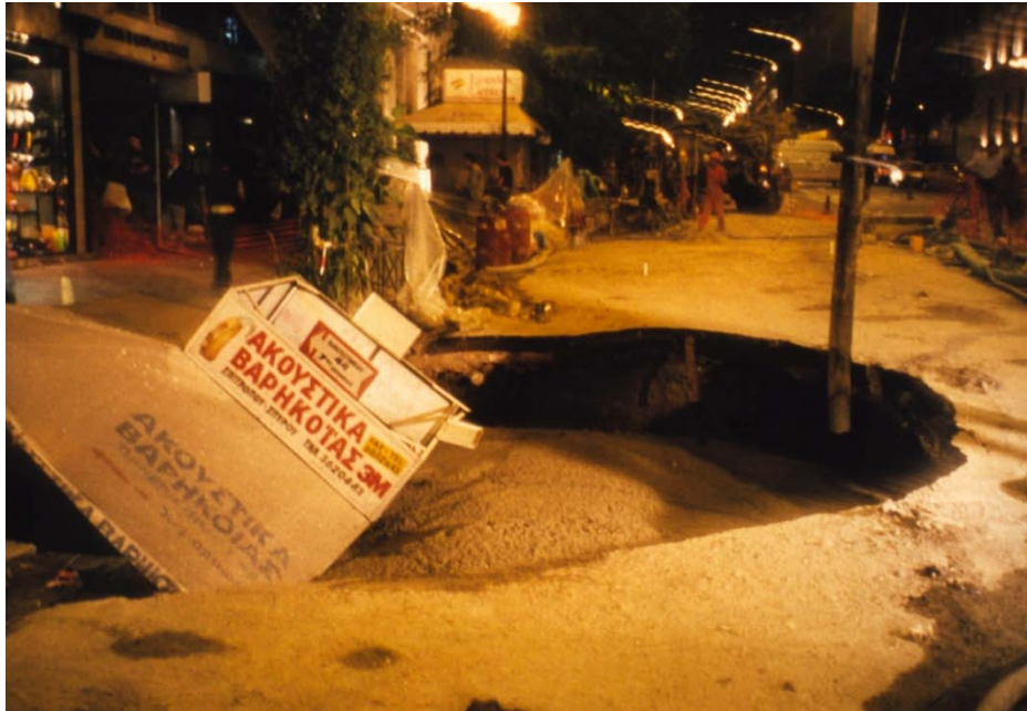
Εικόνα 1.7: Περιστατικό καθίζησης στην οδό Πανεπιστημίου (Μαρίνος, 2008)
