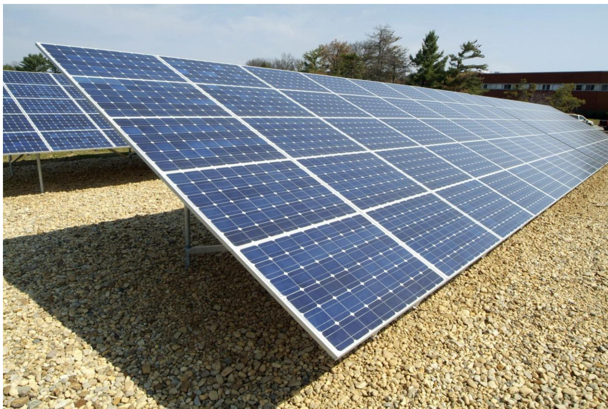
Εικ. 3.5 Φωτοβολταϊκό σύστημα
