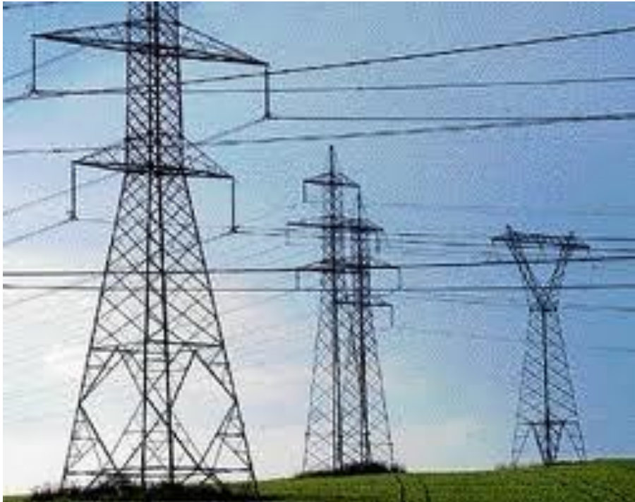
Σχήμα 1.2: Πυλώνες της ΔΕΗ.
