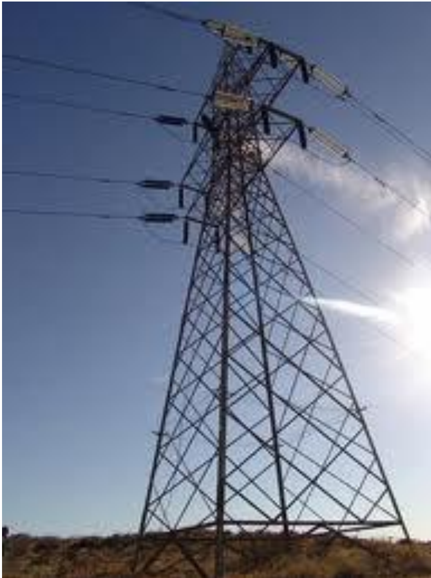
Σχήμα 1.1: Πυλώνες της ΔΕΗ.
