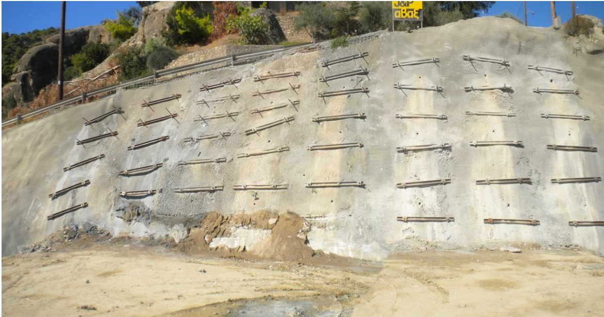
Εικόνα 6.35: Περιοχή του πάνω μέρους του μετωπικού ορύγματος των ανατολικών στομιών, όπου φαίνονται οι ηλώσεις βράχου που εφαρμόστηκαν (Οκτώβριος 2013)
