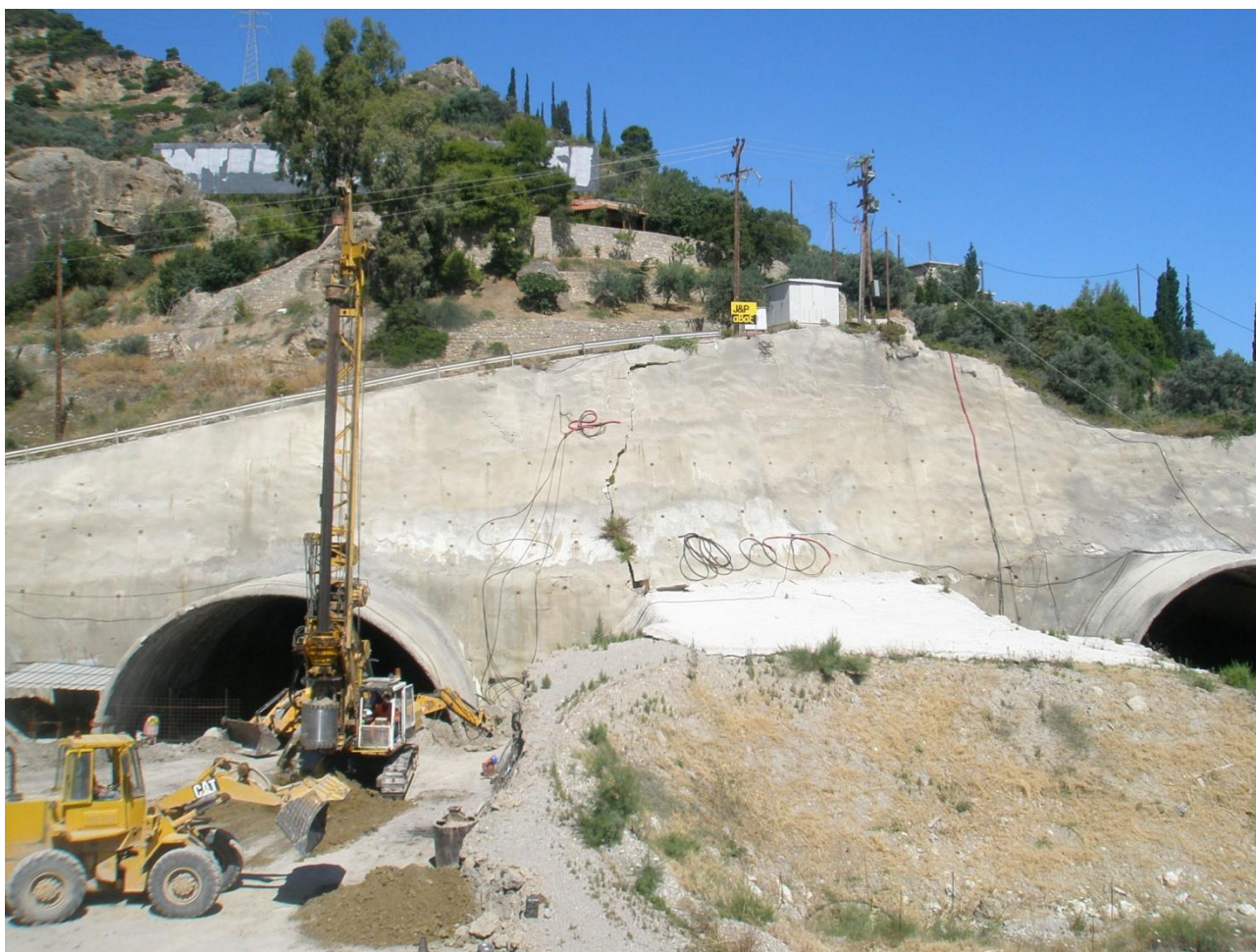
Εικόνα 6.30: Μετωπικό όρυγμα ανατολικών στομίων, όπου είναι εμφανής η ρωγμή στο εκτοξευόμενο σκυρόδεμα (Ιούνιος 2013)
