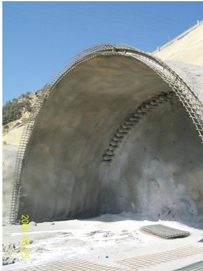
Εικόνα 5.8: Φορέας μεταλλικών προπλαισίων με εκτοξευόμενο σκυρόδεμα στον αριστερό κλάδο των ανατολικών στομιών
