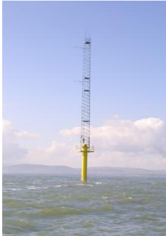
Εικόνα 2. 3. Υπεράκτιος μετεωρολογικός ιστός.
