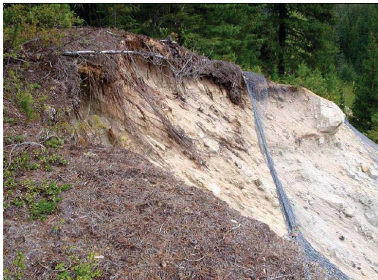
Εικόνα 20: . Αστοχία λόγω αγκύρωσης σε αποσαθρωμένη ζώνη
