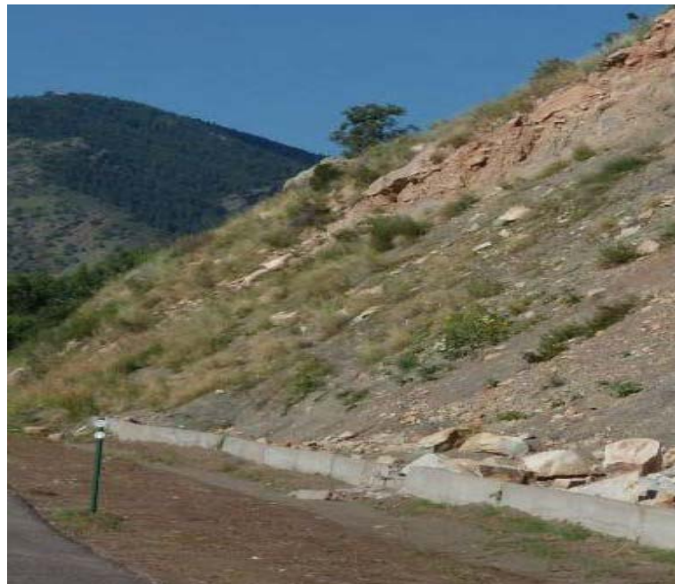
Εικόνα 28: Καταστροφή από την πτώση βράχων
