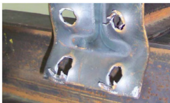
α) αστοχία λόγω διάτρησης του ελάσματος
