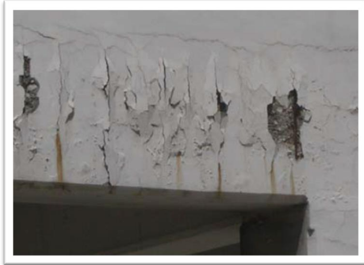
Φωτογραφία 2. Άποψη δοκού που έχει υποστεί αποφλοίωση [Ημερίδα: Θέματα τεχνολογίας σκυροδέματος και δομικών χαλύβων με τα νέα ευρωπαϊκά πρότυπα ΕΛΟΤ EN, Τ.Ε.Ε., Οκτώβριος 2004].
