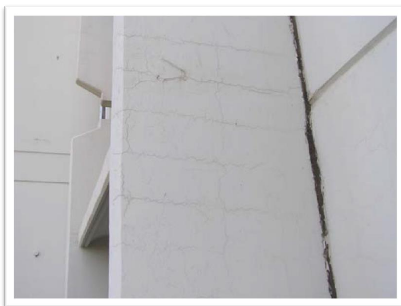
Φωτογραφία 1. Μικρορηγματώσεις σε κατακόρυφα στοιχεία κατασκευής [Πανελλήνιο Συνέδριο Μεταλλικών Υλικών, Νοέμβριος 2004].
