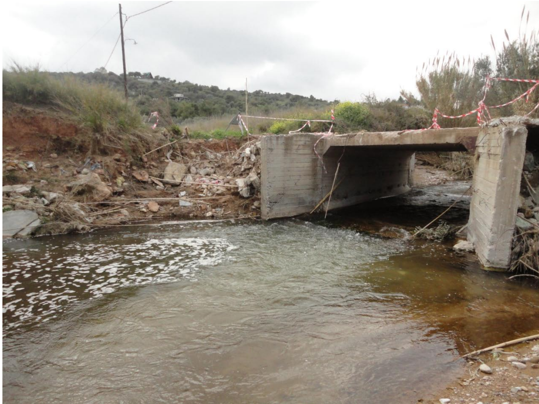
Σχήμα Π1.12: Φωτογραφική απεικόνιση της θέσης δειγματοληψίας RS8, στην οποία παρατηρείται η έντονη διάβρωση της κοίτης.
