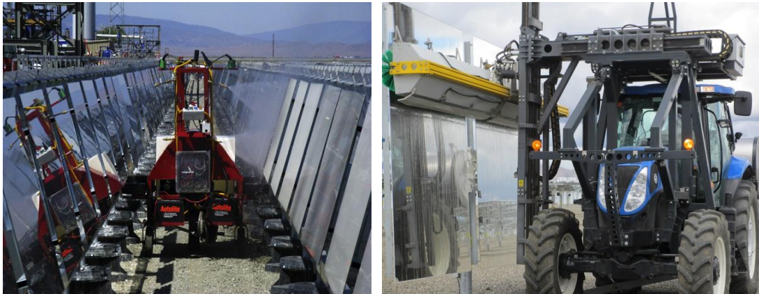
Σχήμα 4.12 Καθαρισμός ηλιοστατών α) με ψεκασμό νερού και β) με τρίψιμο. [83],[73]
