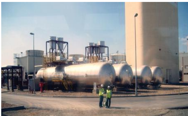
Σχήμα 2.17 Δεξαμενές αποθήκευσης πεπιεσμένου ατμού του ηλιοθερμικού σταθμού PS10 [58]
