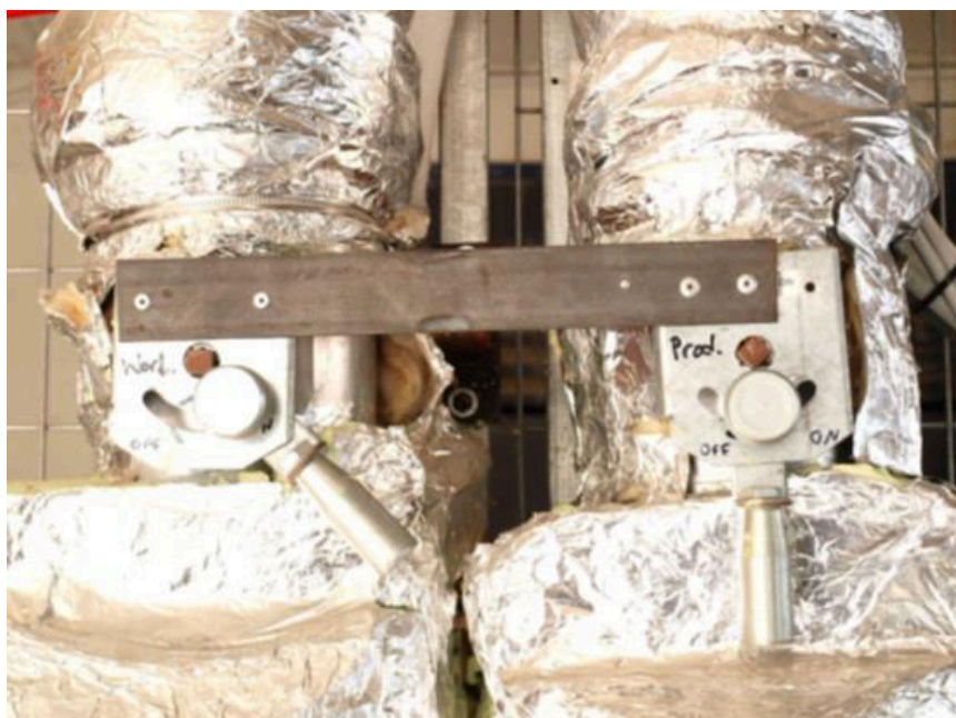
Σχήμα 4.10: Τα dampers και η στήριξη τους· αριστερά διακρίνεται το damper του εργαζόμενου ρεύματος και δεξιά το του ψυχόμενου ρεύματος
