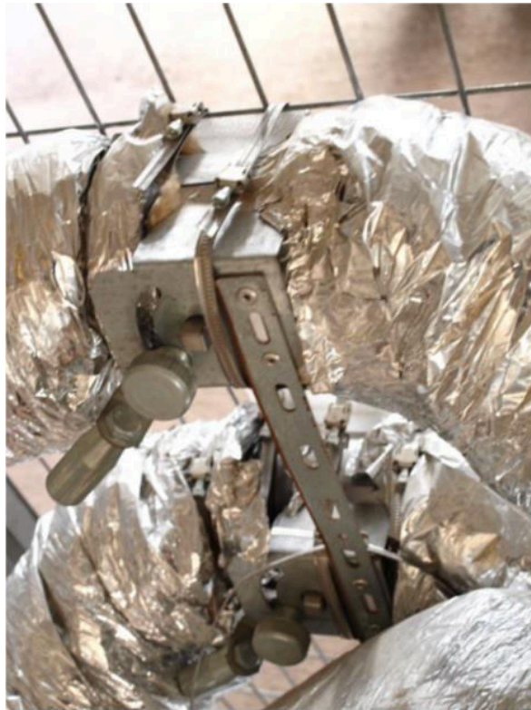
Σχήμα 4.14: Dampers των δύο ρευμάτων αέρα product πριν την είσοδο τους στον εναλλάκτη
