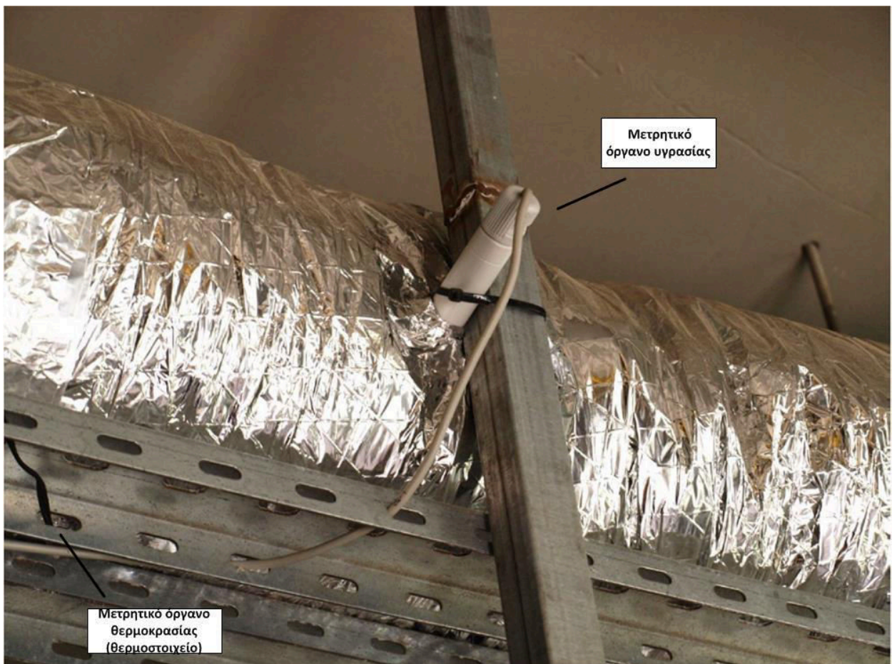
Σχήμα 4.6: Μετρητικά θερμοκρασίας και υγρασίας πριν τον ανεμιστήρα
