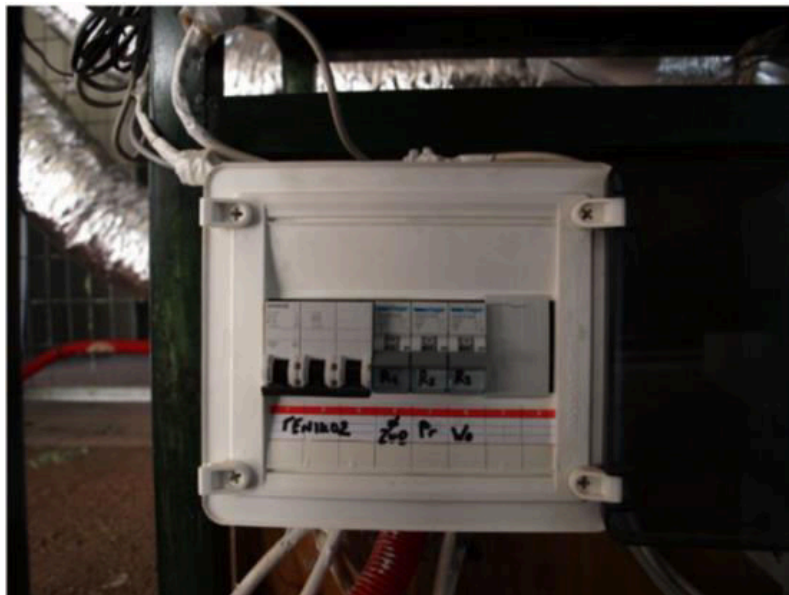
Σχήμα 4.15: Ηλεκτρικός πίνακας της εγκατάστασης
