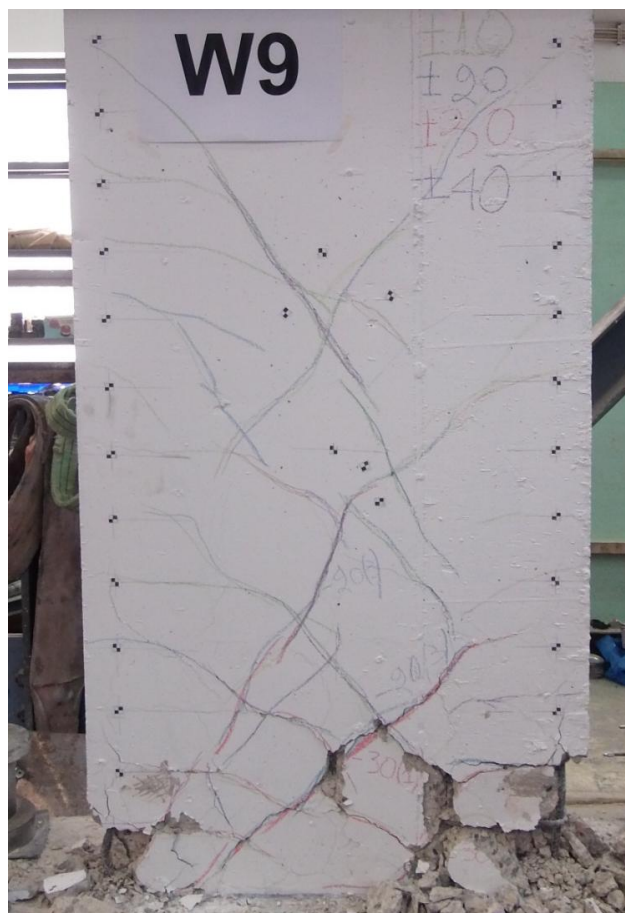
Εικόνα 5.12 Ρωγμές τοιχείου T9 μετά το τέλος του πειράματος
