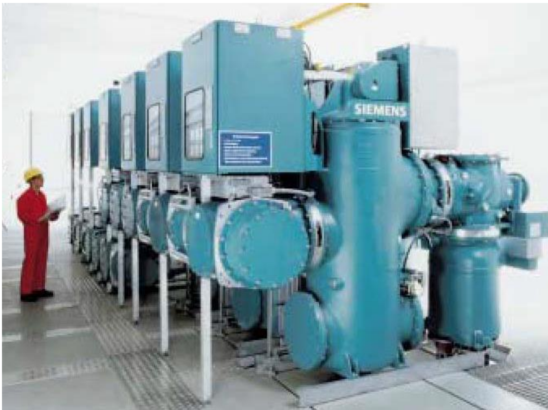
Εικόνα 3: Υποσταθμός με διακόπτες GIS με αέριο SF 6 145 kV σε στεγασμένο χώρο.
