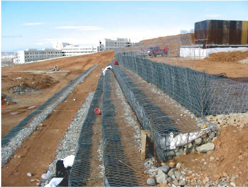
Εικόνα 2-9 : Κατασκευή οπλισμένου επιχώματος στη περιοχή ελικοδρομίου στο νέο Στρατιωτικό Νοσοκομείο 424 Θεσ/νίκης ( www.geognosi.gr )
