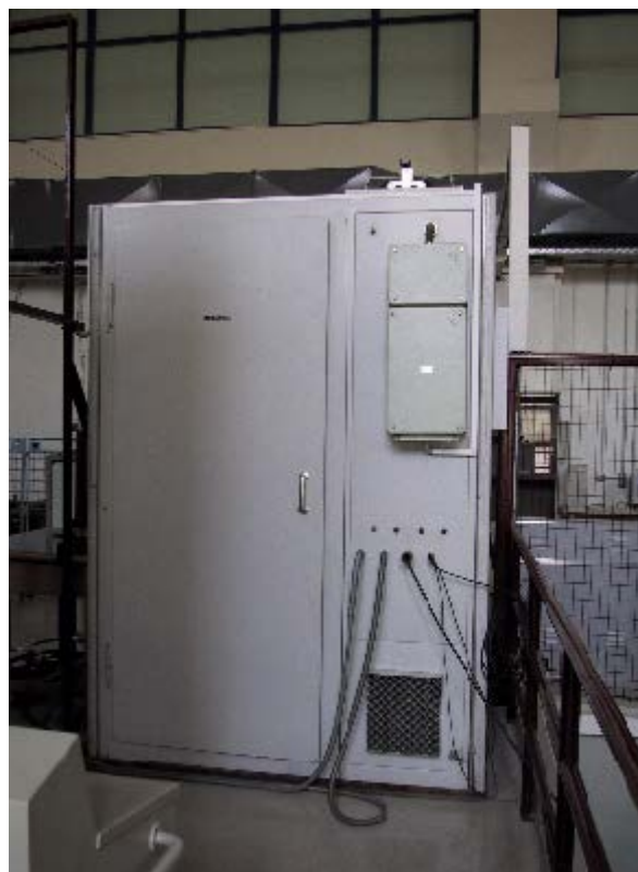
Εικόνα 5.7: Θωρακισμένος θάλαμος Siemens
