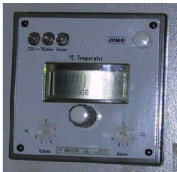
Εικόνα 4.6: Αυτόματος ελεγκτής θερμοκρασίας-υγρασίας
