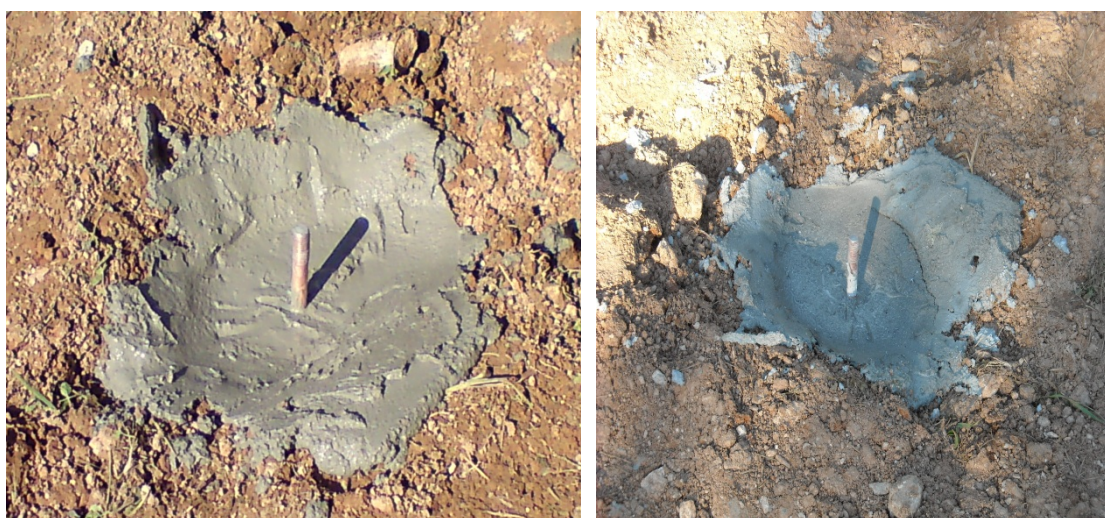
Εικόνα 5.6: Ηλεκτρόδια γείωσης εμβαπτισμένα σε μπετονίτη και σκυρόδεμα.
