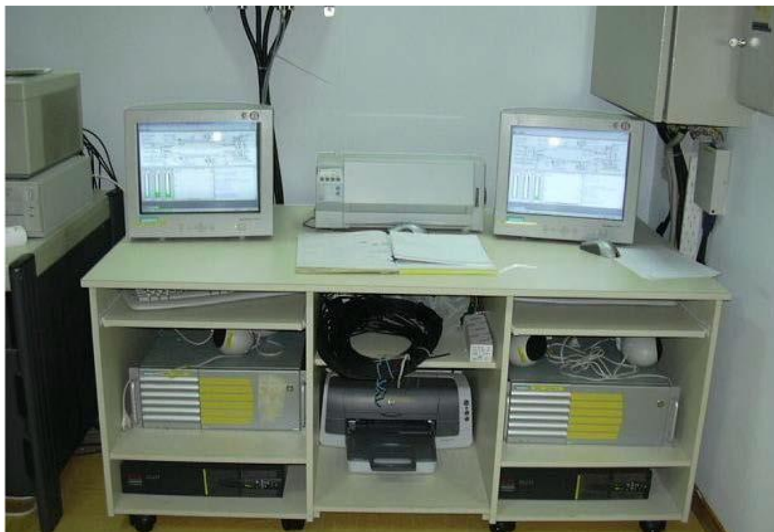
Σχήμα 3.1: Εγκατεστημένο διαγνωστικό σύστημα στη Μονάδα ΙΙΙ του Λαυρίου από το ΕΘΣ/ΕΜΠ. (ΕΘΣ/ΕΜΠ, 2005)
