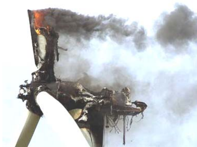
Εικόνα 8: Ολική καταστροφή ανεμογεννήτριας από πυρκαγιά Picture 8: Total destruction of a wind generator caused by fire
