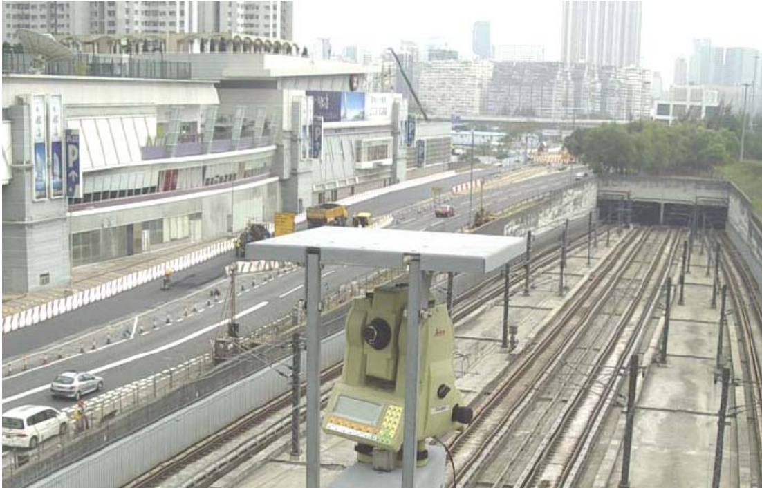
Εικόνα 50: Συνεχής παρακολούθηση συμπεριφοράς σήραγγας σιδηροδρομικής γραμμής (Hong Kong Airport Express Line)
