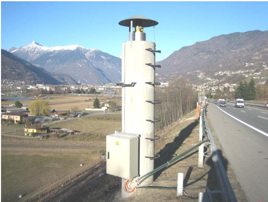
Εικόνα 51: Παρακολούθηση δυναμικής συμπεριφοράς τεχνικών έργων αυτοκινητόδρομου (Lucerne, Switzerland)
