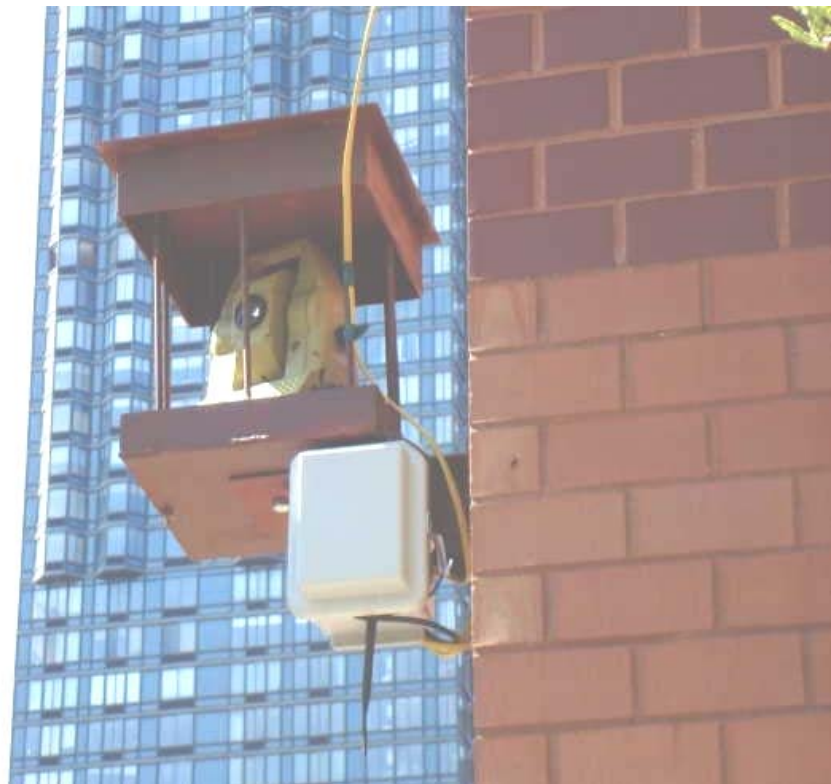
Εικόνα 53: Παρακολούθηση μικρομετακινήσεων κτιριακών εγκαταστάσεων (Manhattan, New York)
